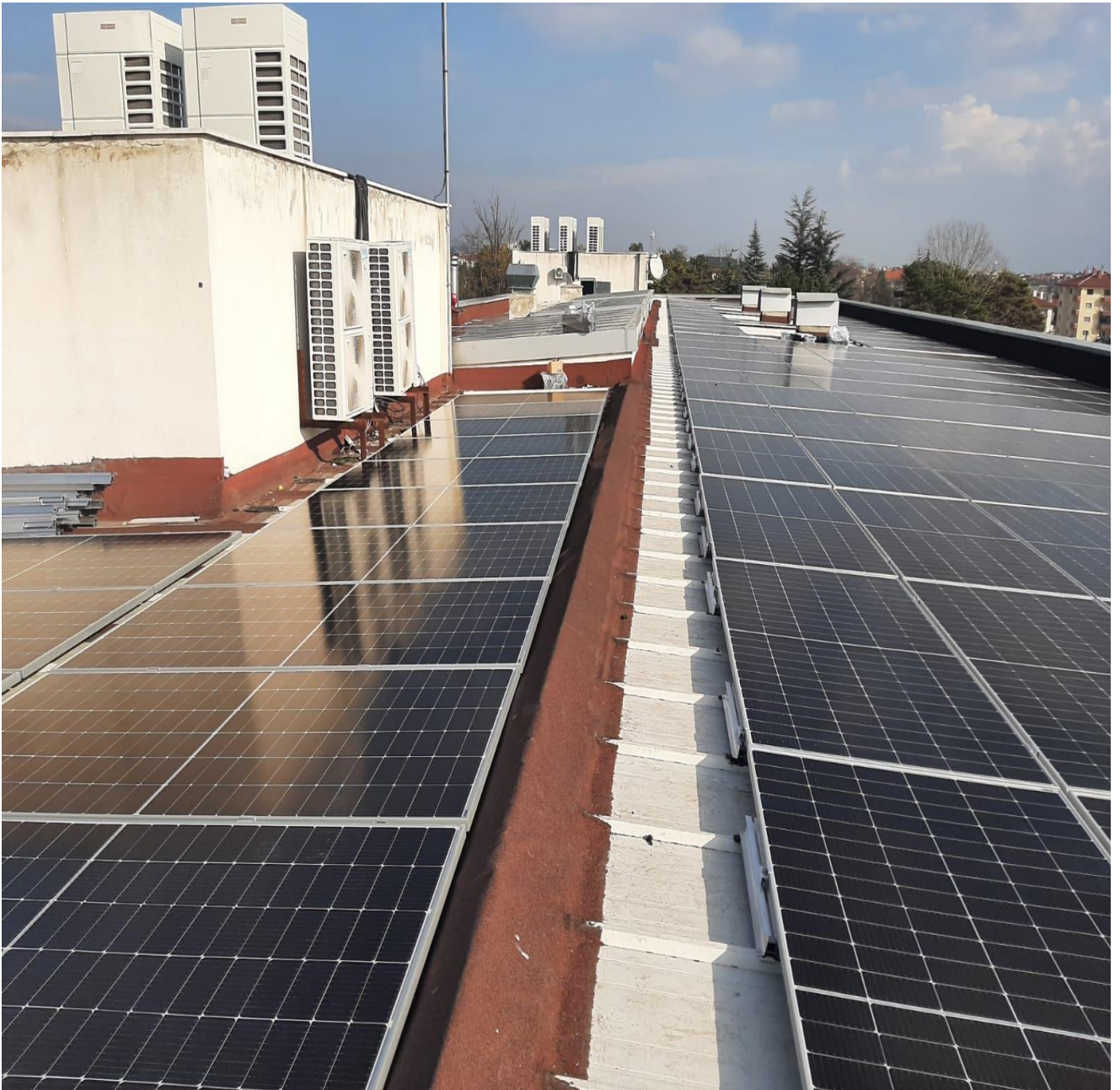
Bolu İl Özel İdaresi Bina Çatısı 240 KW Güneş Enerji Santrali Kurulumu
